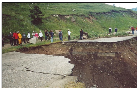
Рис.4. Разрушенное полотно автодороги выше с. Артаваз (фото В.Р. Бойнагряна).
